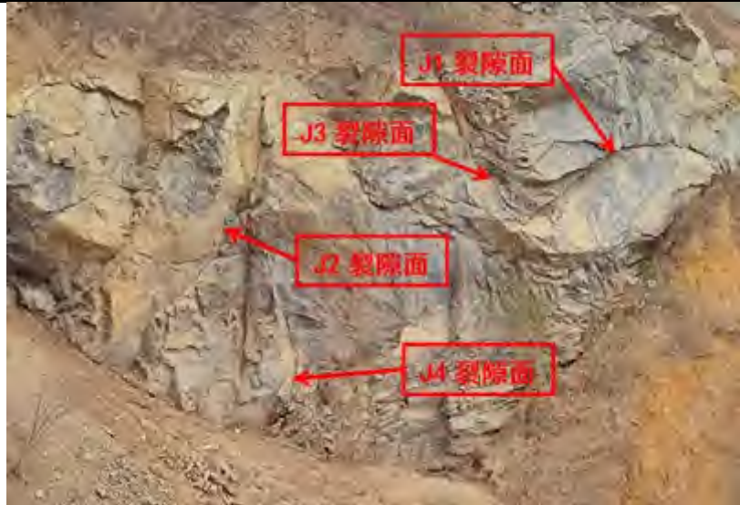
图3-9 4#矿坑岩体裂隙面状况
